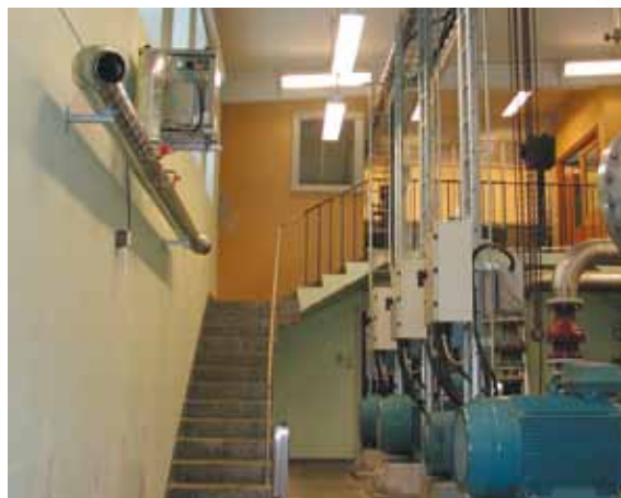
Installerad DR-031C i vattenverk i Sverige.
